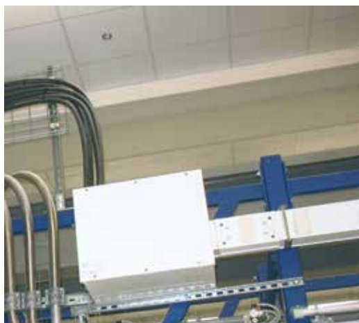
Canalis KS and sprinkler.
